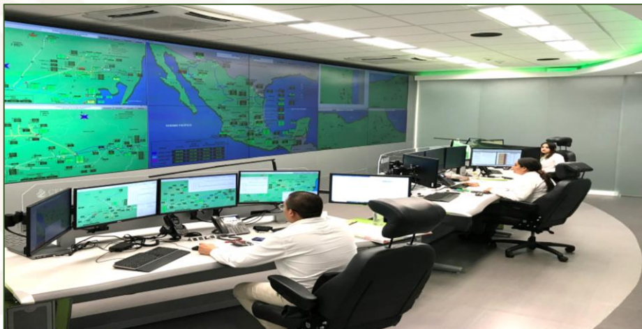
CENTRO DE CONTROL PRINCIPAL OFICINAS CENTRALES DE CENAGAS
